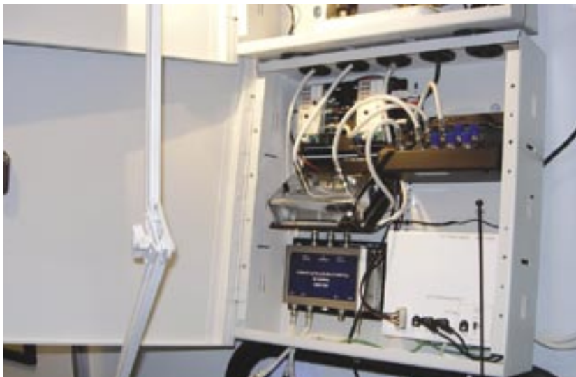
Рис. 8. Коммутационный центр кабельной системы EuroLAN Mini
